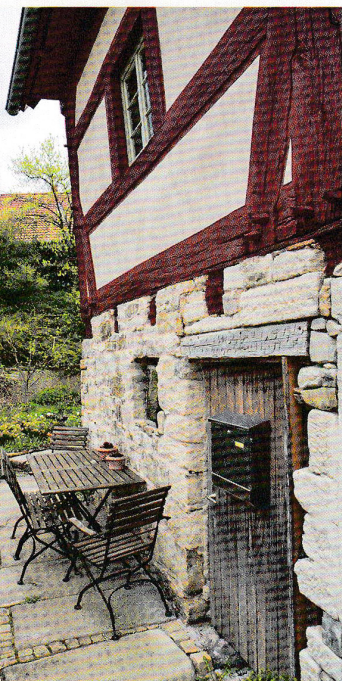
Für die Gefache der Außenfassade ihres spätmittelalterlichen Denkmals rührte das Ehepaar Schreiber-Knaus eine Kalktünche an.
