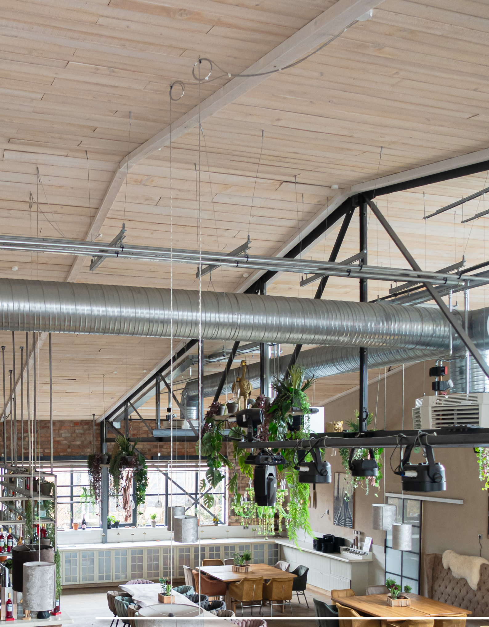
Gaststätte Villa da Angelo in Hildesheim, Decke mit sägerauen Brettern ohne Oberflächenschutz
